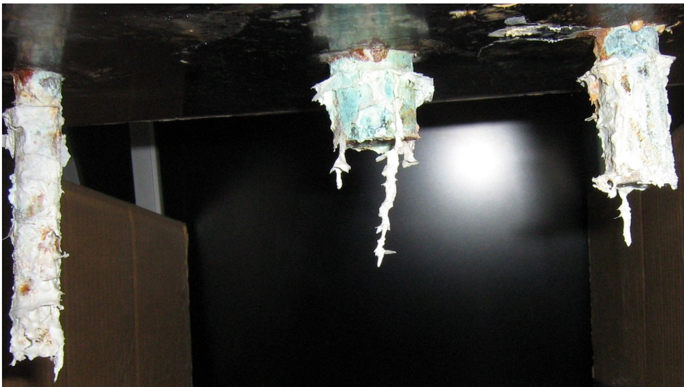
Figura nr.3. Electrozii L, N si R, dupa 15 ani de functionare si depozitele de coroziune sub forma de helictite
